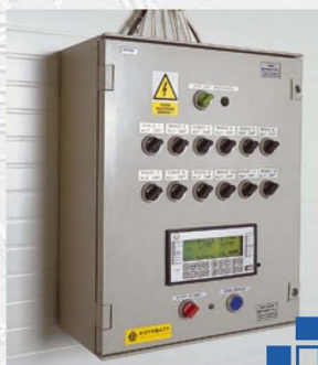
ROZVADEČ S ŘÍDICÍ JEDNOTKOU
