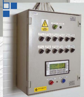
ROZVADEČ S ŘÍDICÍ JEDNOTKOU
